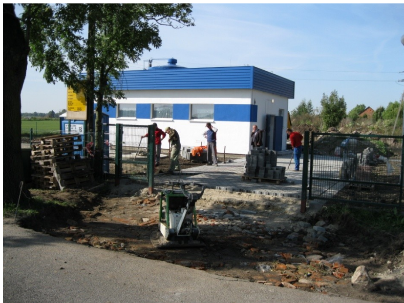
Fot. 11 Stacja uzdatniania wody w Boguszynie
